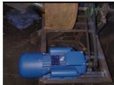
(d) Electric motor connected to drum
